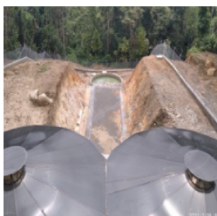
Alcantarillado y planta de tratamiento de aguas residuales para la población Santa Rita de Archidona. Cantón Archidona provincia del Napo.
